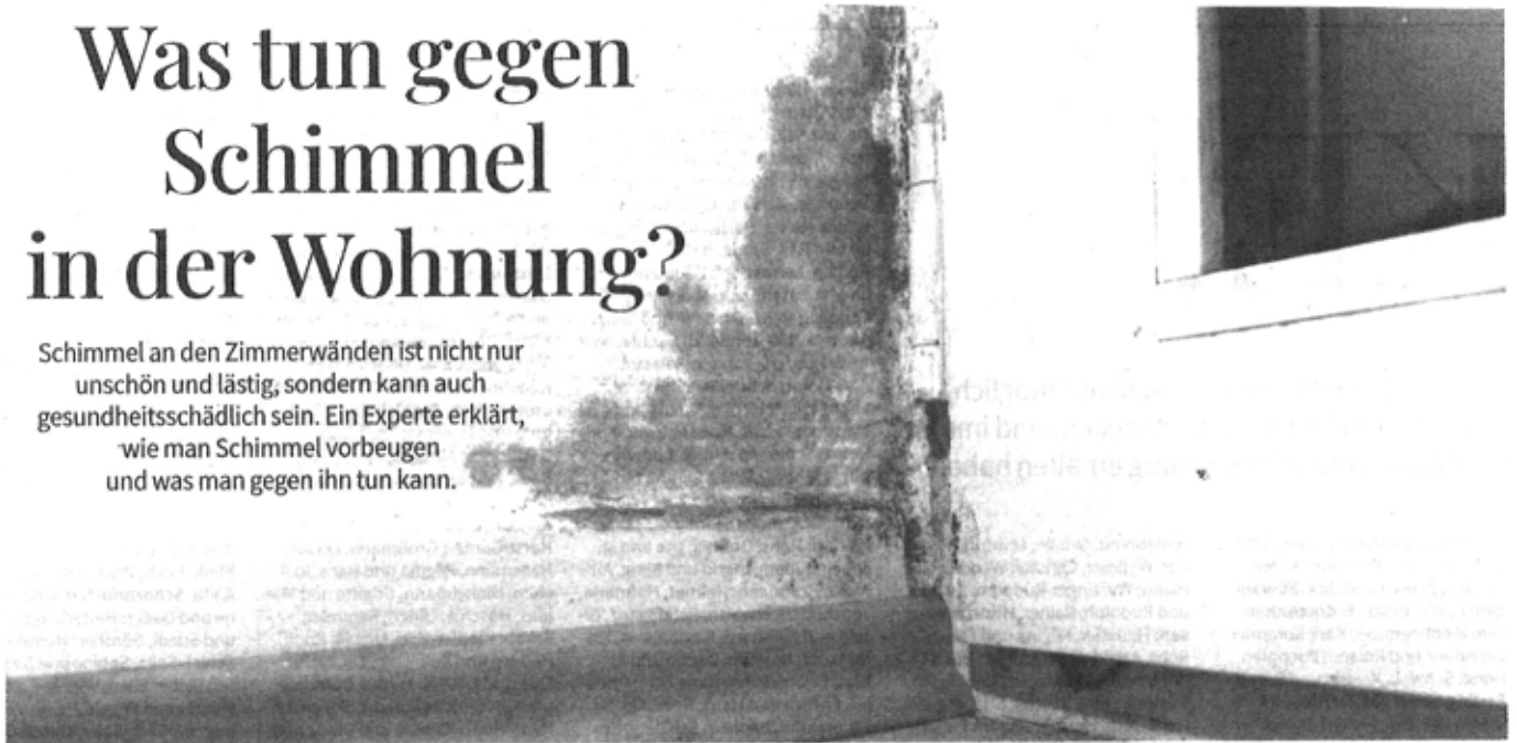
Oft sind Zimmerecken zur Außenwand hin besonders stark betroffen.
